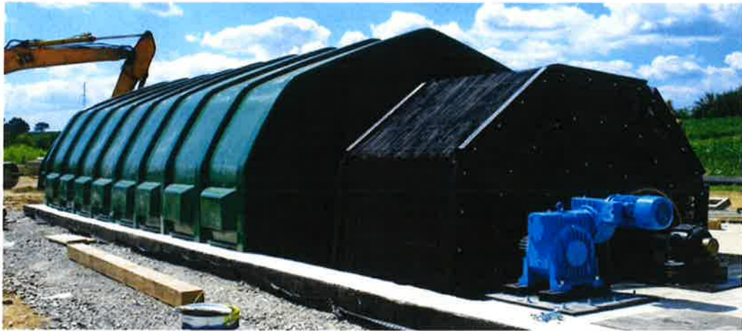
Slika 10 Tip pročistača koji je ugrađen u tvornici aluminija
