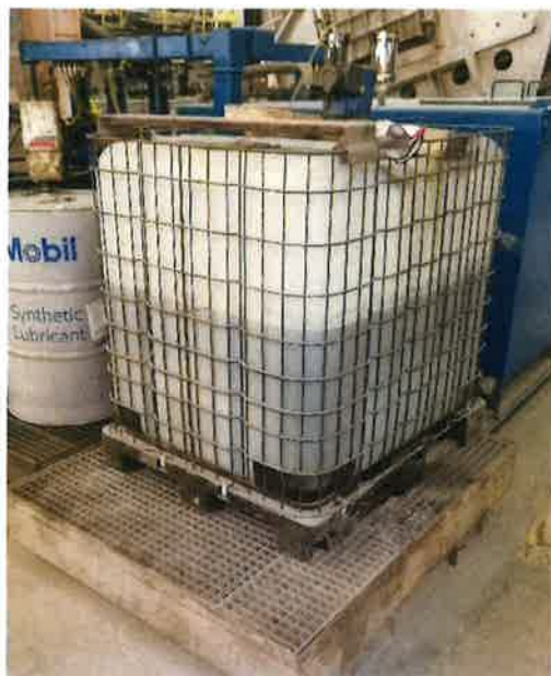
Slika 5 Primjena tankvana u tvornici aluminija
